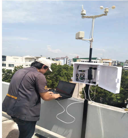
ภาพที่ 6 สถานที่ติดตั้งอุปกรณ์
