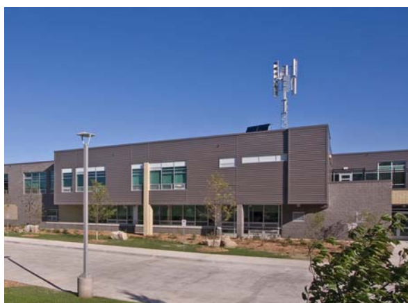
ภาพที่ 2 กังหันลมแกนแนวตั้งที่ติดตั้งบนอาคาร
