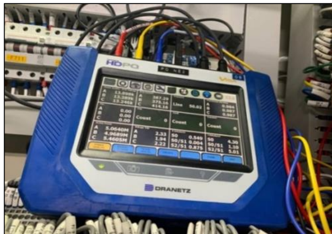
ภาพที่ 12 หน้าจอแสดงการนับบันทึกค่าแรงดันไฟฟ้าและจำนวน Vsag Vswell ของเครื่อง Dranetz HDPQ
